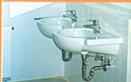
Die 5-Personen-Wohnungen sind jeweils mit Doppelwaschbecken ausgestattet.
