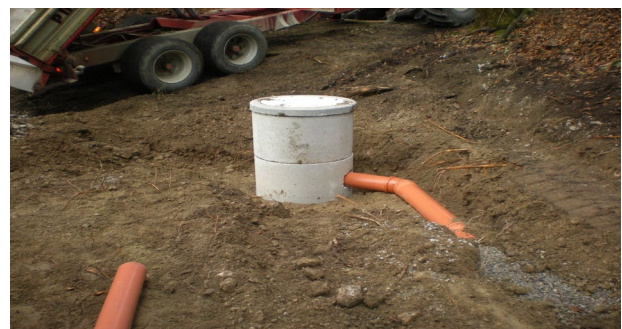
Abbildung 12: Probenahmeschacht (Quelle: Anlagenbau Ebner)
