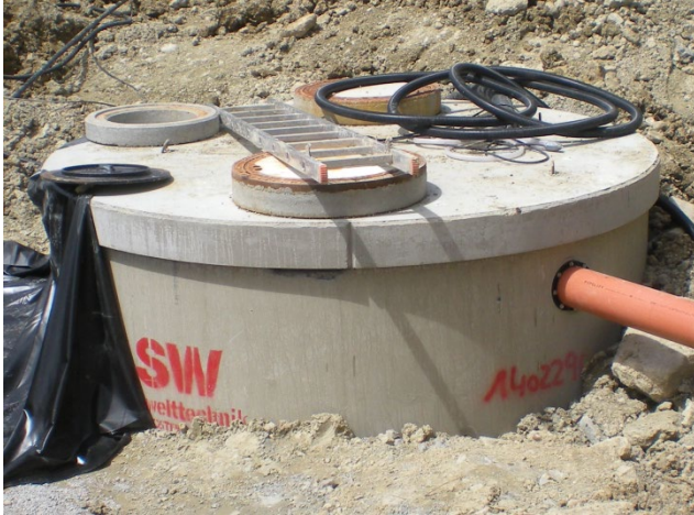
Abbildung 2: Das Bild zeigt eine technische Anlage kurz vor der Fertigstellung (Quelle: Anlagenbau Ebner)
