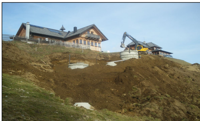
Abbildung 1: 2-stufige Tropfkörperanlage einer Almgastwirtschaft mit anschließender Versickerungsanlage (Quelle: SW Umwelttechnik)
