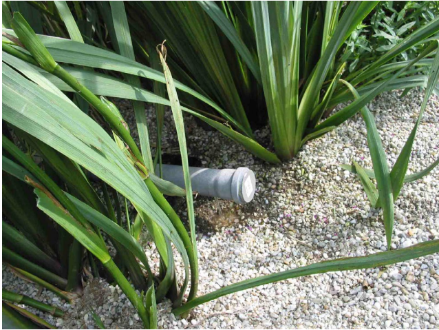
Abbildung 10: Bepflanzter Bodenfilter (Quelle: Büro Steinbacher)
