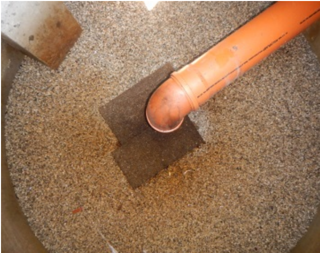
Abbildung 9: in der Mitte des Sickerschachtes ist eine Prallplatte angeordnet um das Abwasser zu verteilen (Quelle: Referat Gewässerschutz)
