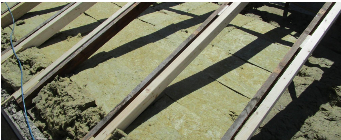
Abbildung 1: Mineralwolle aus dem Baustellenbereich
