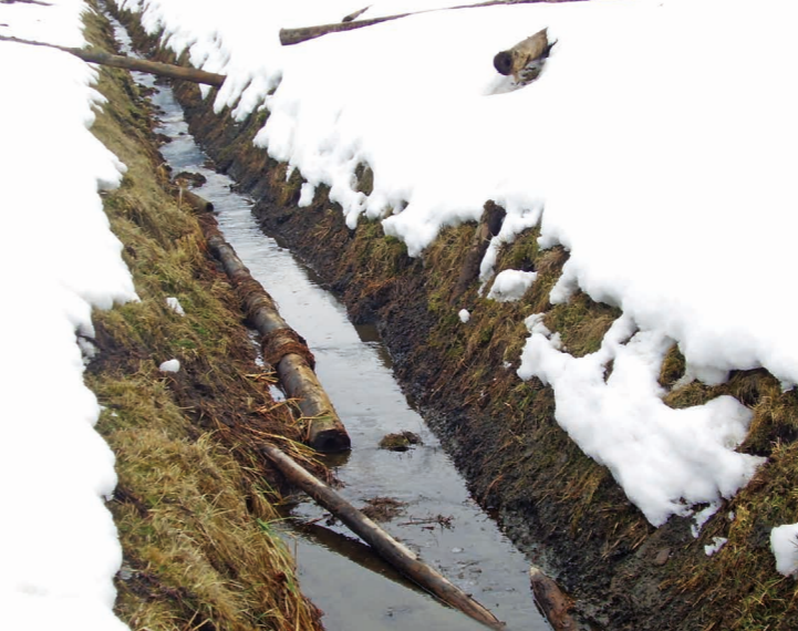
Ökologische und bauliche Zerstörung des Entwässerungsgrabens
