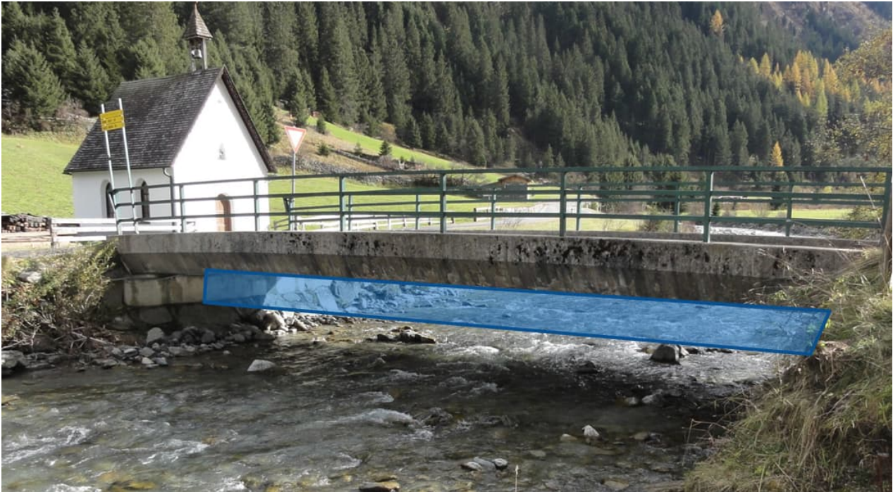
Abbildung 7: Annahme bei Brückenverklausungen. Die Reduktion des Abflussquerschnittes ist in BLAU dargestellt
