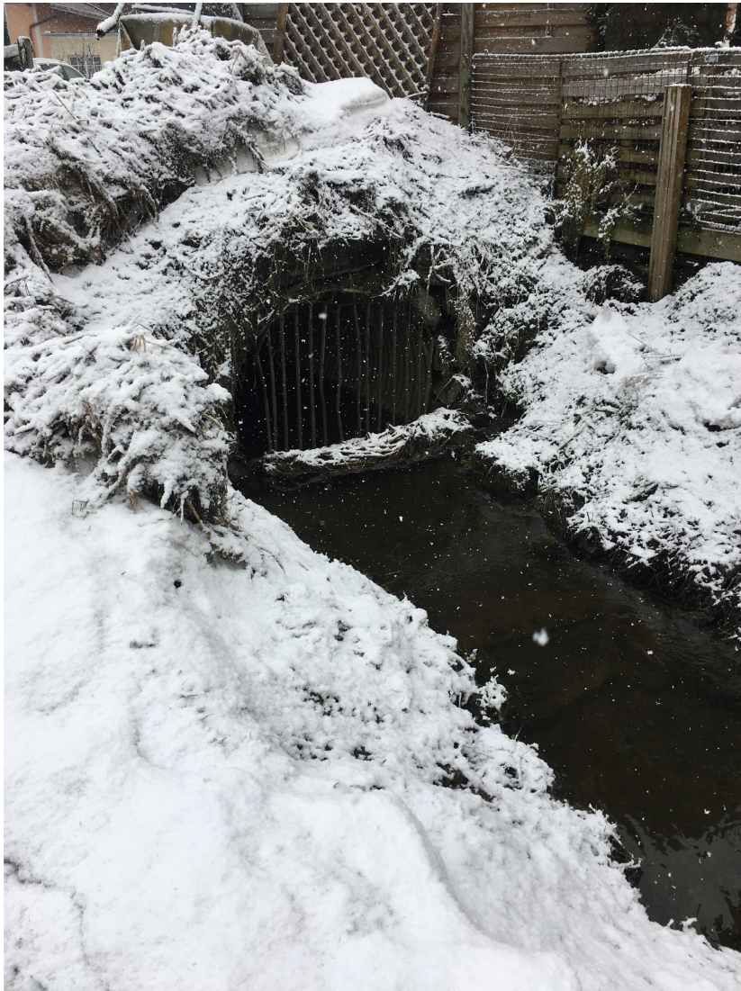
Abbildung 5: Annahme einer möglichen Verkläusung des Einlaufes der Verrohrungsstrecke Bruckbergkanal
