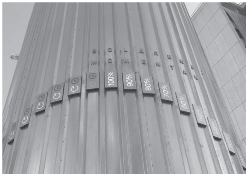
Auf dem großen Pufferspeicher wird immer der aktuelle Eintrag an Sonnenenergie angezeigt.
