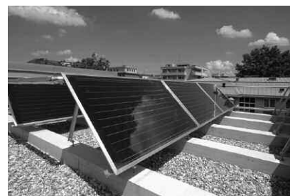
Solaranlagen für die Wärmeversorgung der Wohnanlage Eshaverstraße.
