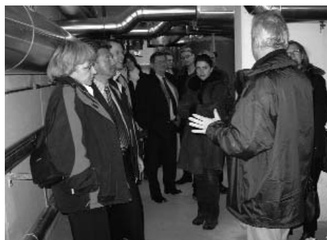
Hr. Meisl (gswb) erläutert die ausgefeilte Haustechnik mit Nutzung von Solarenergie in der Gartenstadt Aigen.
