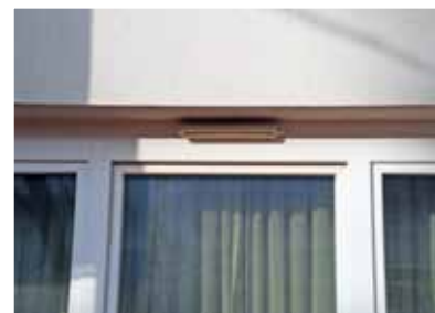
Feuchtegesteuerte Lüftungselemente sorgen für gute Luftqualität
