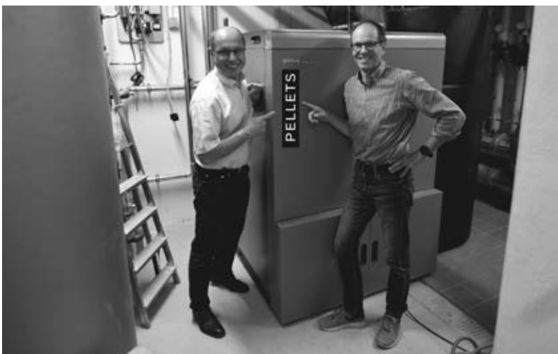
Bgm. Herbert Walkner, e5-Betreuer Manfred Koblmüller; Der neue Pelletskessel versorgt das Gemeindeamt, das benachbarte Mehrzweckgebäude und die Feuerwehr in St. Koloman.
