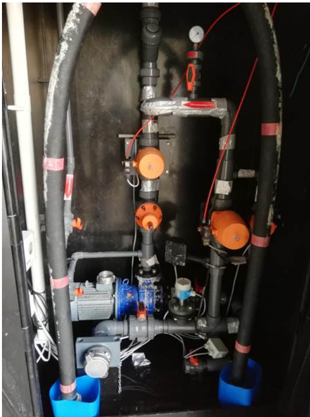
Abbildung 2 Bild einer Pumpenstation zur Befüllung der Lagertanks
