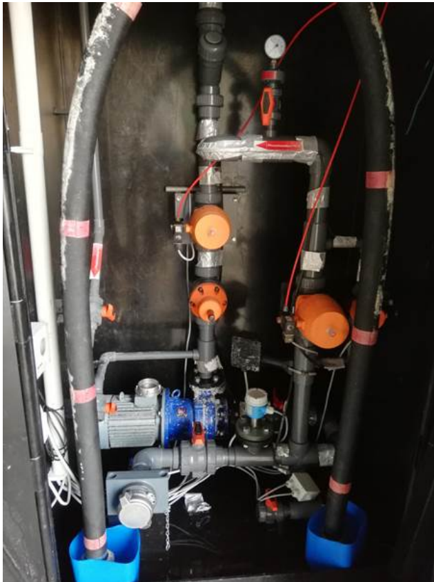
Abbildung 1 Bild einer Pumpenstation zur Befüllung der Lagertanks
