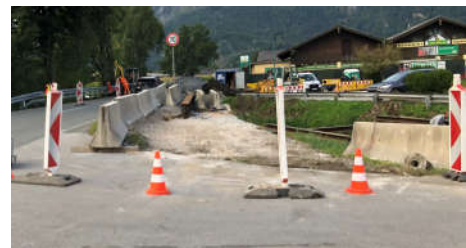
Abb. 3: In Bau befindliche Verlängerung des Geh- und Radweges bei der Brücke über den Almkanal
