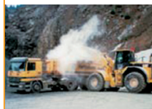
Wo gebaut wird, entsteht (Fein)staub.
