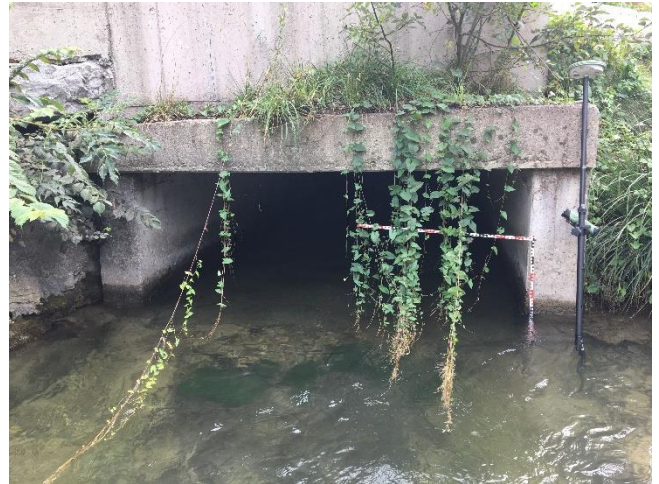
Abbildung 12: Detailaufnahme Zulauf Sägewerksanlage Enzinger
