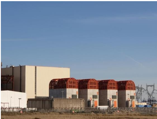
Dieselbetriebene letzte Notstromaggregate (DUS) von 3 MWe
