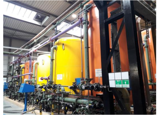
Entsalzungsstation des Kraftwerks von Tricastin
