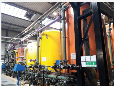
Entsalzungsanlage des Kernkraftwerks Tricastin
