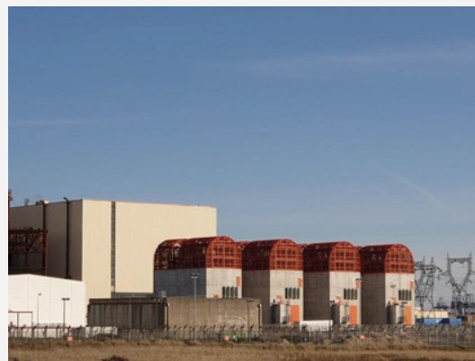
Diesels d'Ultime Secours (DUS) de 3 MWe
