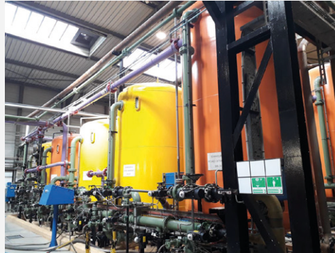
Station de déminéralisation de la centrale du Tricastin
