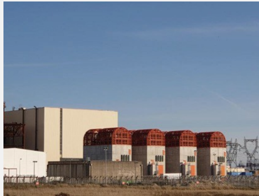
Dieselgeneratoren für den Notfall (DUS) mit 3 MWe
