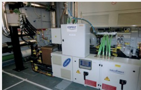
Neue Kältemaschine (+ 50 % Kühlleistung)
