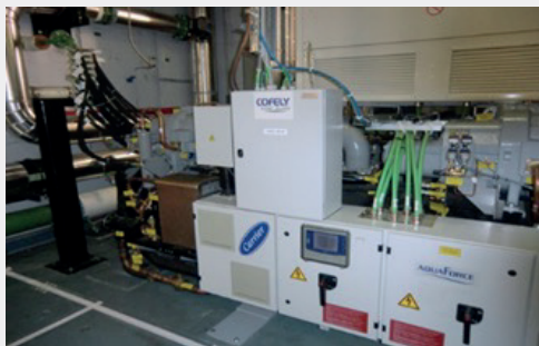
Nouveau groupe froid (+ 50% de capacité frigorifique)
