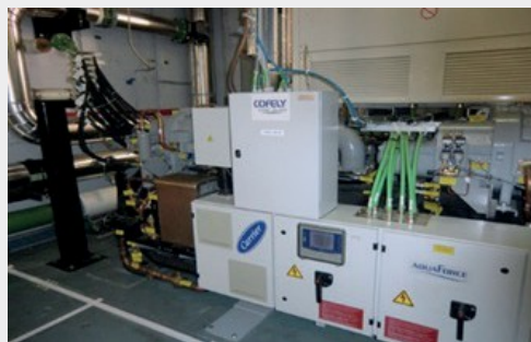
Neue Kältemaschine (+ 50 % Kühlleistung)
