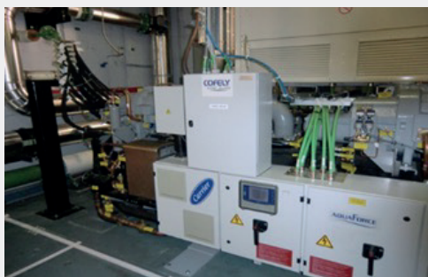
Nouveau groupe froid (+ 50% de capacité frigorifique)
