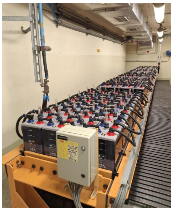
Figure 6. Photo des locaux contenant les batteries
