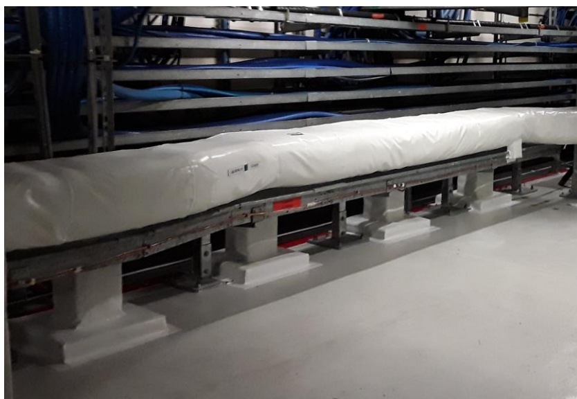
Figure 4. Exemple de protection de chemin de câbles
