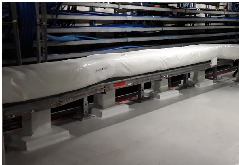
Figure 5. Exemple de protection de chemin de câbles
