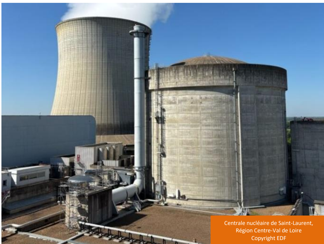
Figure 13. Photo du dispositif d'éventage et de filtration de l'enceinte (filtre U5)
