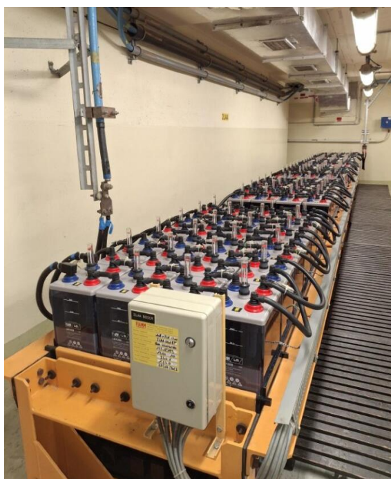
Figure 7. Photo des locaux contenant les batteries
