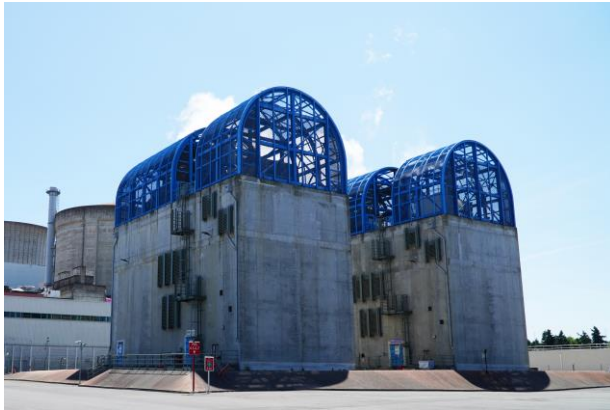
Dieselbetriebene letzte Notstromaggregate (DUS) von 3 MWe
