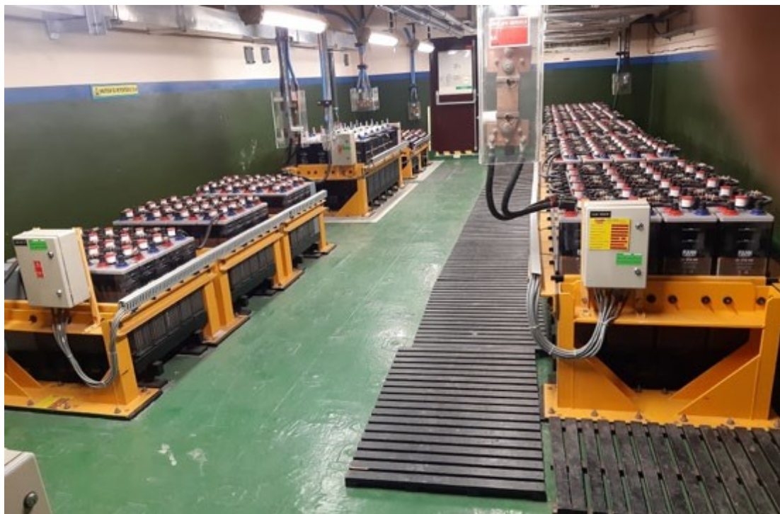
Abbildung 8. Foto der Räume, in denen sich die Batterien befinden
