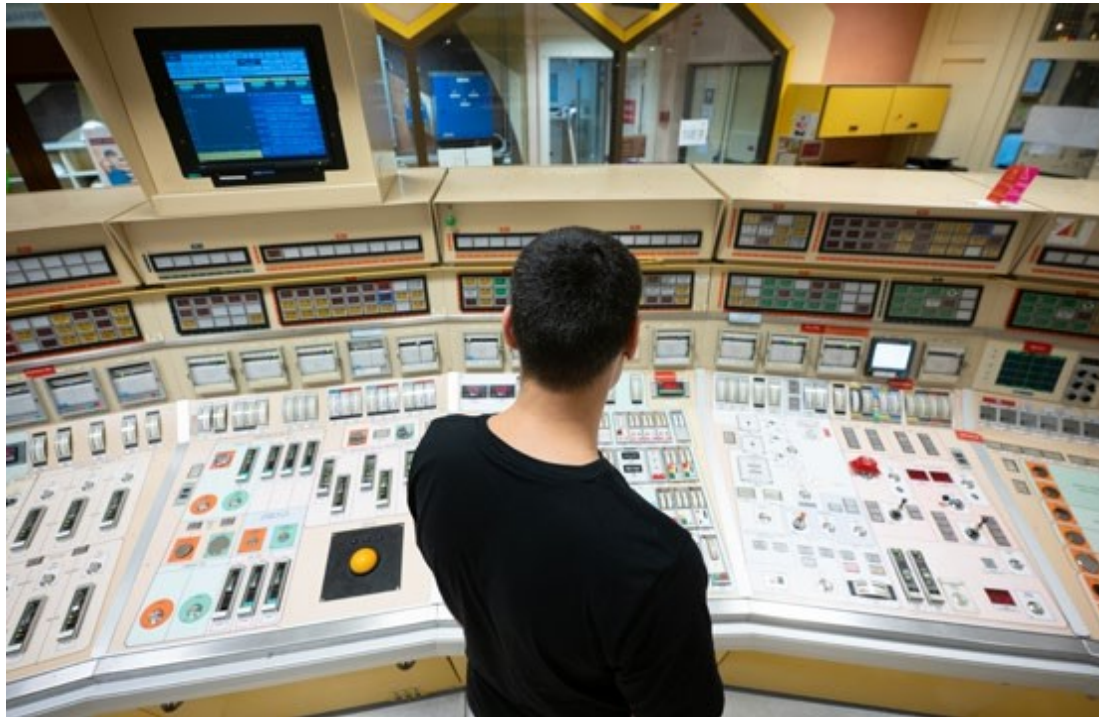
Abbildung 21. Kontrollraum eines 900-MWe-Reaktors (Copyright EDF / DAMPIERRE / Romain BEAUMONT)
