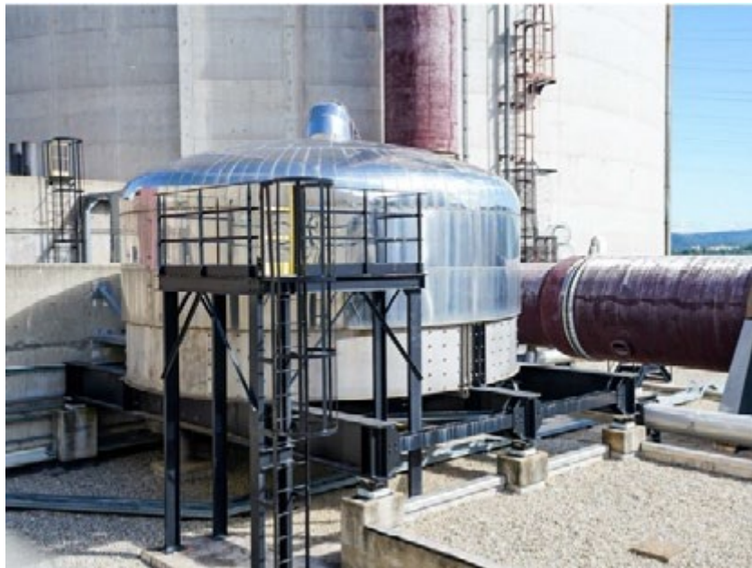
Abbildung 15. Foto der Entlüftungs- und Filteranlage des Sicherheitsbehälters (Filter U5)
