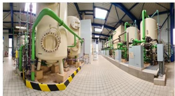
Entsalzungsstation des Kraftwerks von Dampierre-en-Burly © EDF
