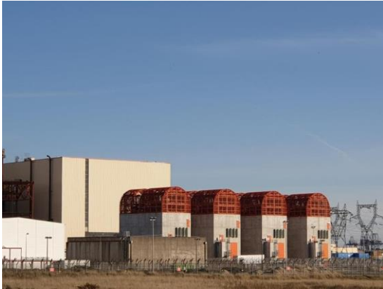
Dieselbetriebene letzte Notstromaggregate (DUS) von 3 MWe
