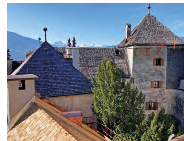
Schloss Lichtenberg thront auf einem Felsvorsprung über Saalfelden. Teile des Daches mussten erneuert werden.
