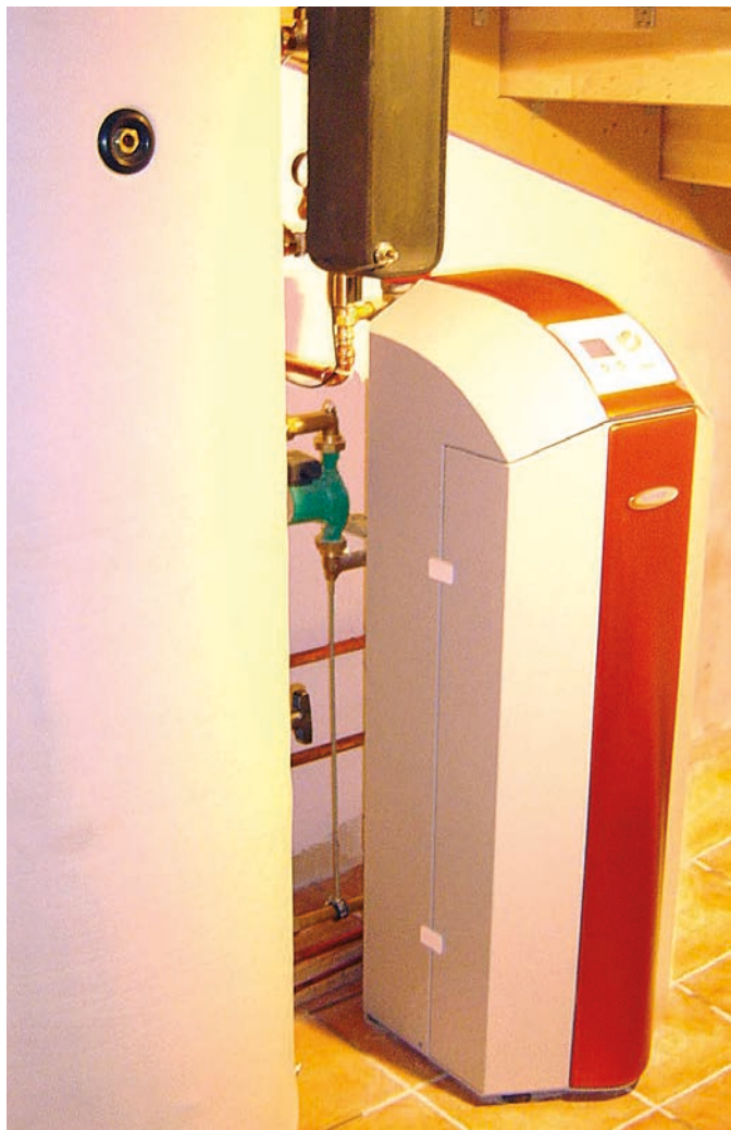
Wärmepumpe (Fa. Heliotherm)
