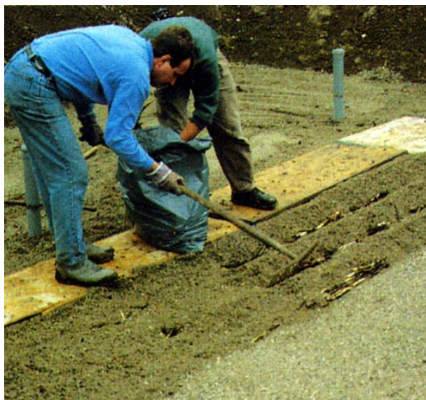
Bepflanzung des Bodenfilters
