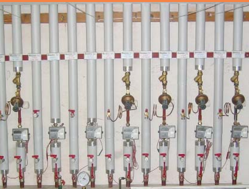
Alle Leitungen werden bis zum letzten Ventil gedämmt um Wärmeverluste zu vermeiden
