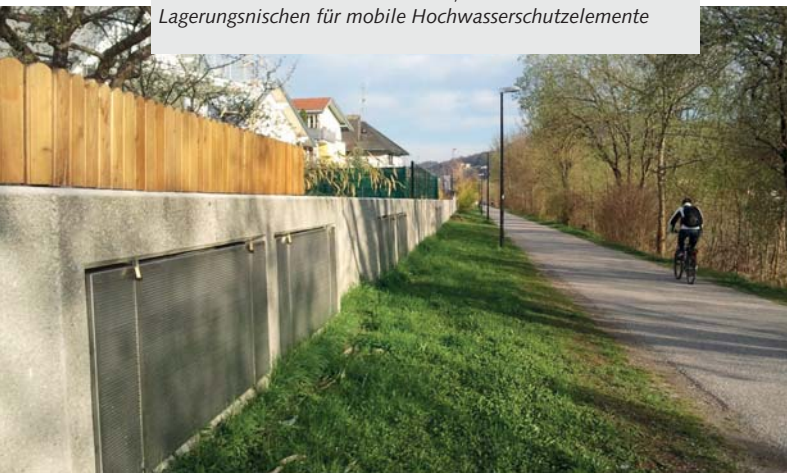
Hochwasserschutz Hinterholzerkai, Josefiou Lagerungsnischen für mobile Hochwasserschutzelemente
