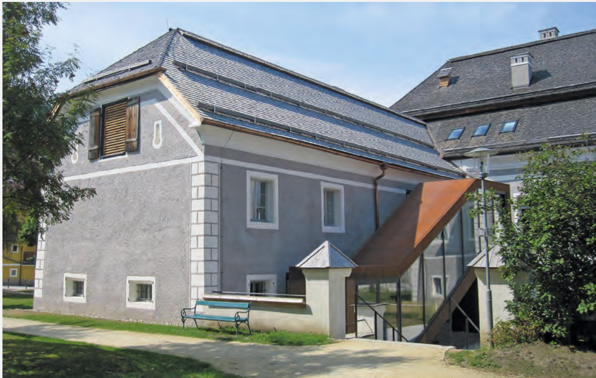
Das Schloss Kuenburg in Tamsweg nach der Sanierung mit modernem Seitenaufgang. Fotos: Christian Haller
